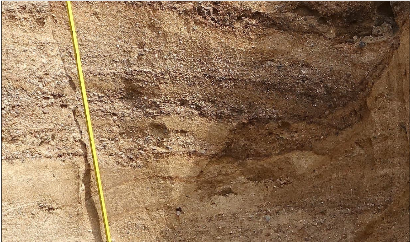
Рис. 3. Вертикальные трещины во флювиогляциальных отложениях московского горизонта. (Фото В.А. Зайцева)
